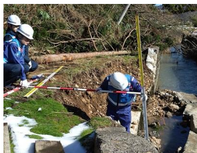
河川被災状況調査
